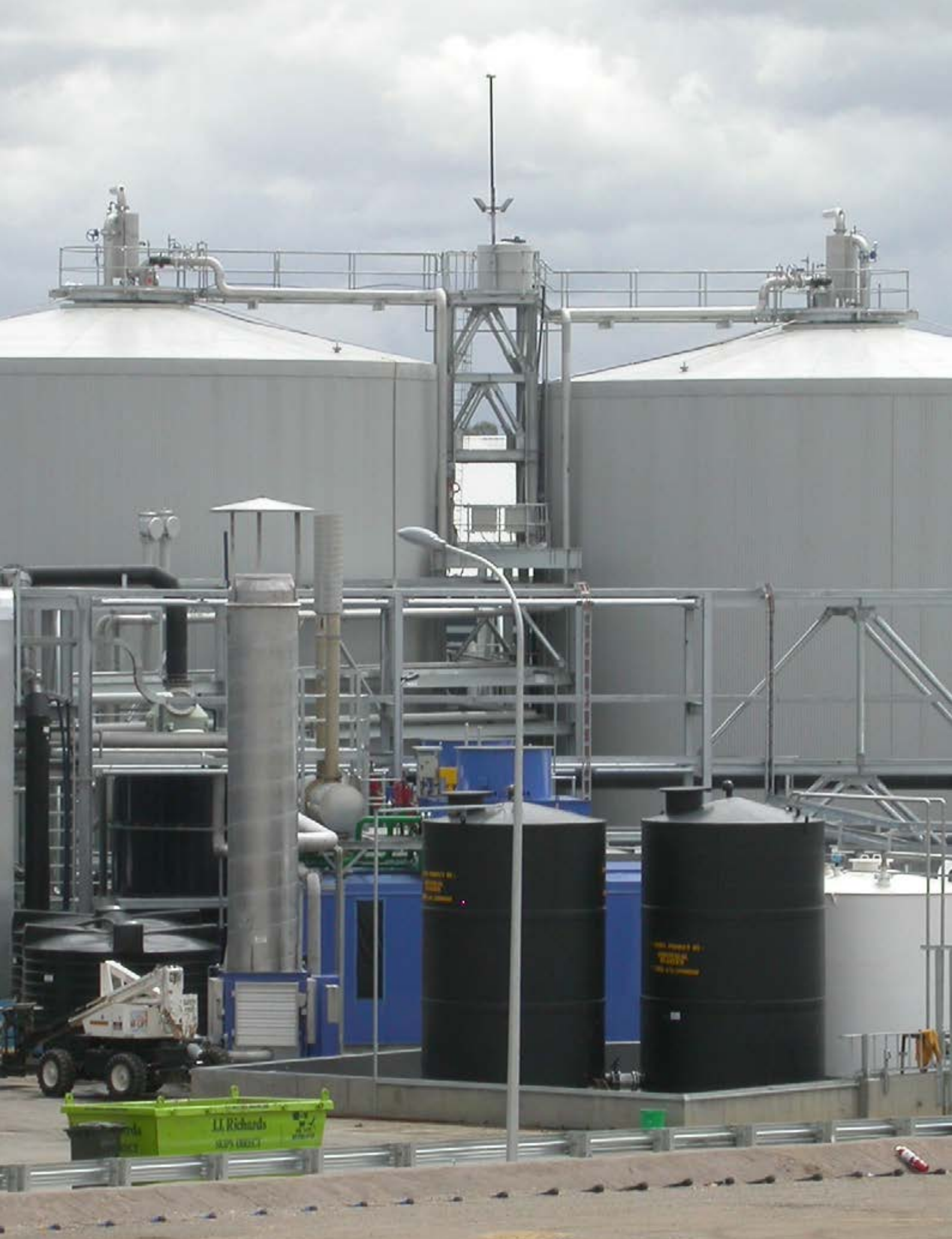
Abbildung 9: Aufbereitung der flüssigen Phase aus Grünabfällen in einem Hybridreaktor (unten im Fermenter UASB, oben Anaerobfilter) (Foto: Triple E&M)
