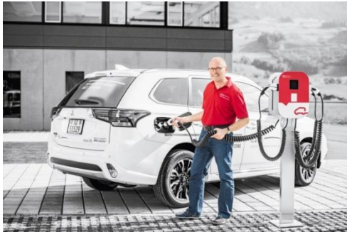
Bild: EWS setzt auf Elektromobilität und installierte auf dem neuen Firmenareal vier Elektrotankstellen.
