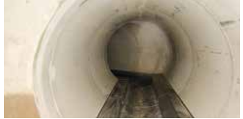
Sohlenwärmetauscher am Boden eines Abwasserkanals
