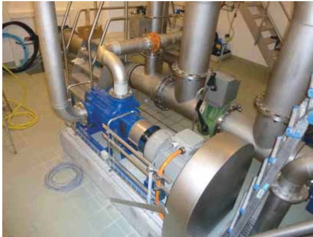
Standard-Pumpe als Turbine (rückwärtslaufend)
